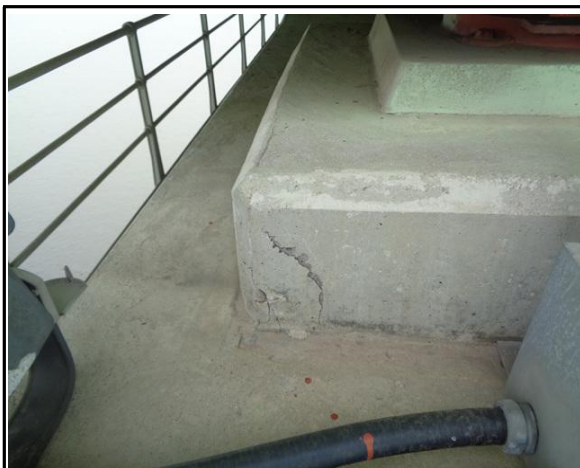
인천방향 MP23-SH3 받침콘크리트 파손
