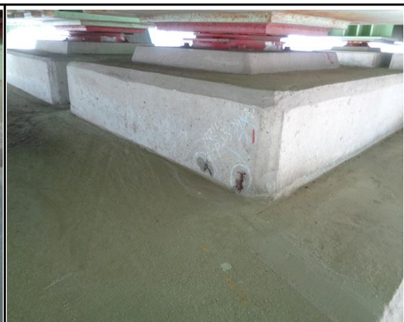
인천방향 MP23-SH4 받침콘크리트 철근노출
