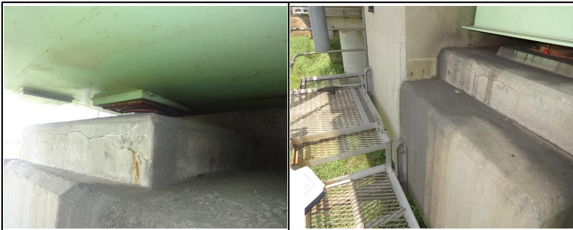
교량받침 HP4-SH4 받침콘크리트 들뜸
