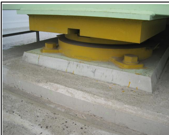
일산방향 MP10-SH1 받침몰탈 균열
