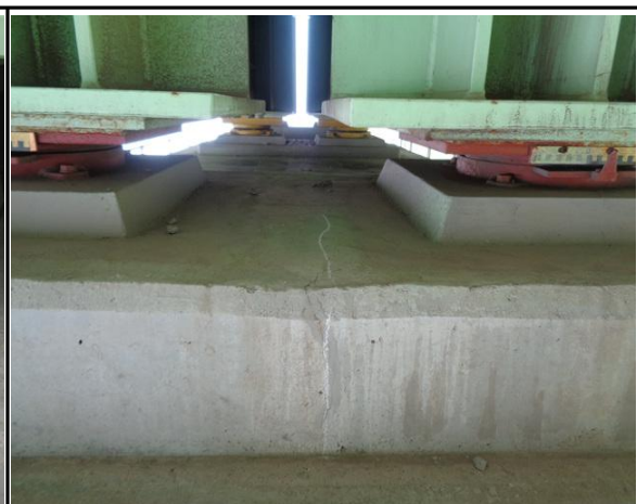
일산방향 MP26-SH6 받침콘크리트 균열
