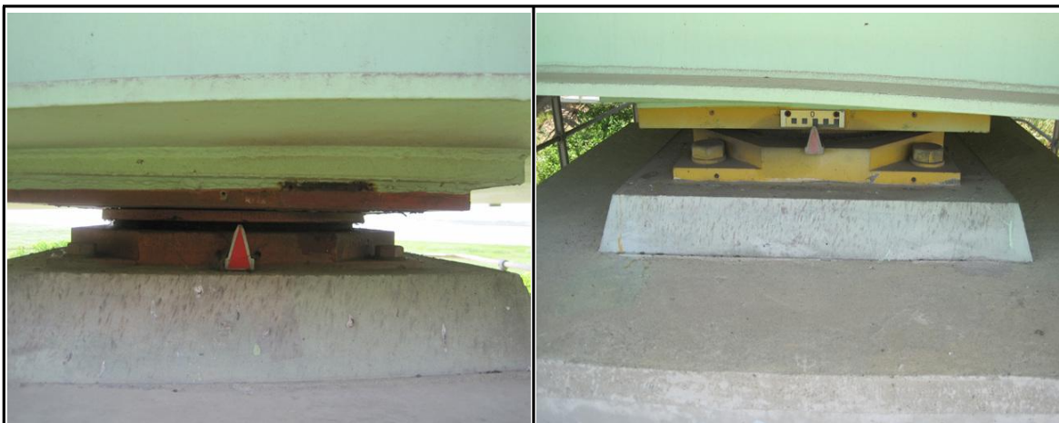
교량받침 GP4-SH1 이동량 측정자 파손
