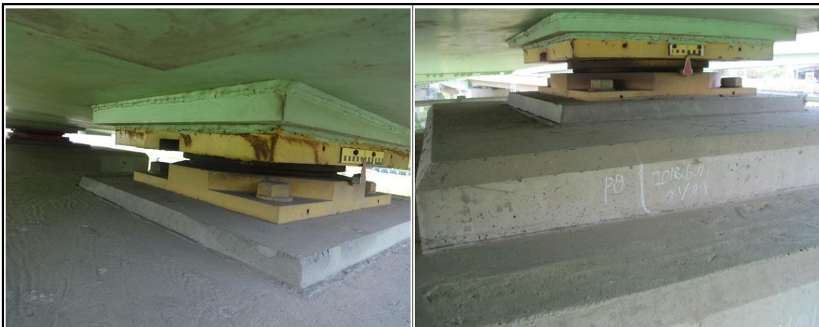
교량받침 HP6-SH1 녹발생
